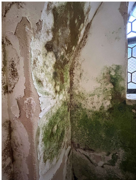
Foto B: Feuchtigkeitsschaden im Ausspracheraum Hinterwand.
