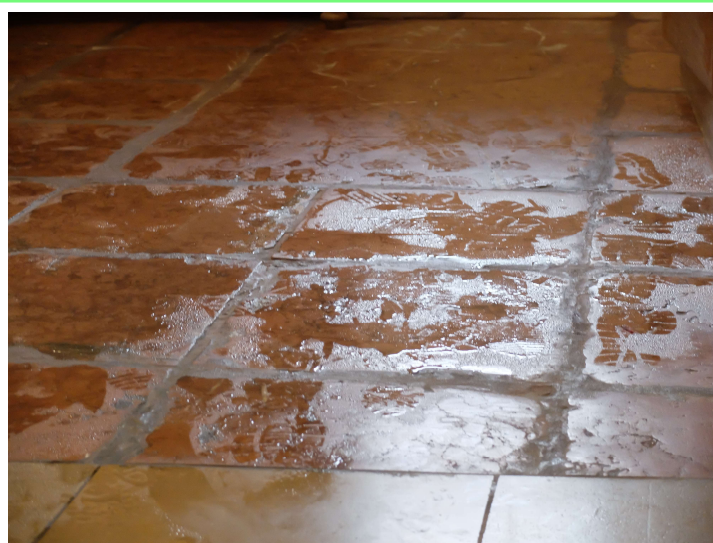
Foto A: Wasserpfüten am Boden.
